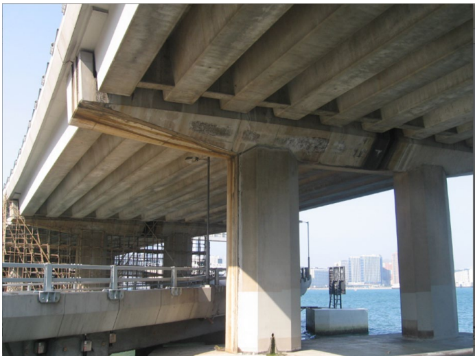
簡支樑橋身之伸縮縫常漏水
